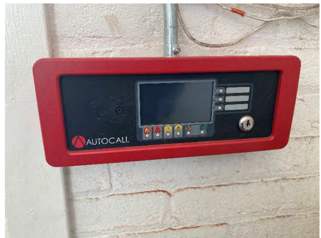
M-16. Bldg 5733E: Fire alarm panel.
