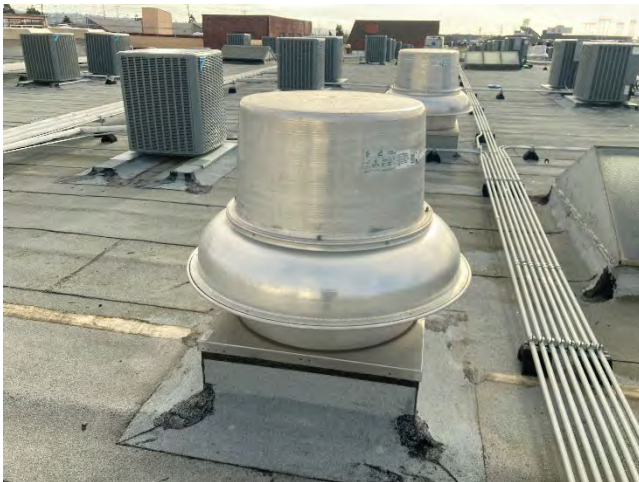
M-3. Bldg 5733W: Rooftop exhaust fan.
