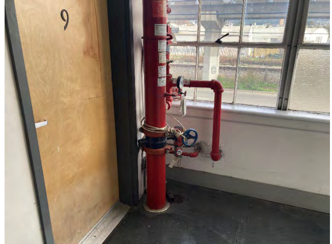
M-14. Bldg 5733E: Fire sprinkler riser.
